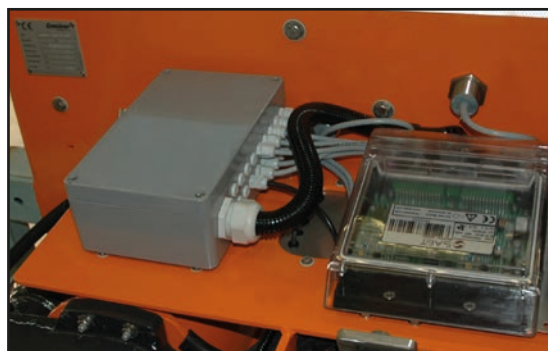
Fordelerkasse med Blackbox i enhedsrummet
