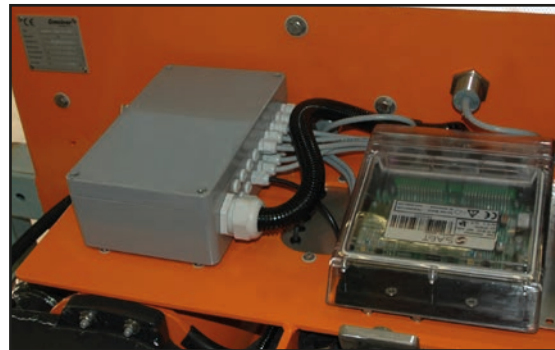
Verteilerkasten mit Blackbox im Geräteraum
