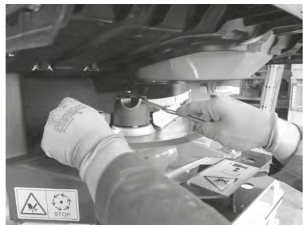
Σχ. 37: Χαλάρωση τυφλού παξιμαδιού
