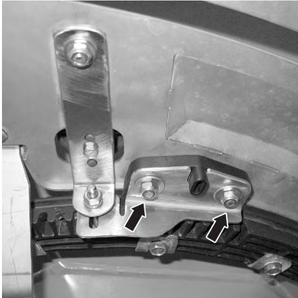
Σχ. 62: Χαλάρωση ελάσματος ευθυγράμμισης σημείου εφαρμογής
