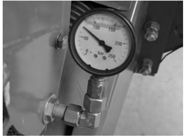
Fig. 122: Manometer på kabelstyrning över draget
