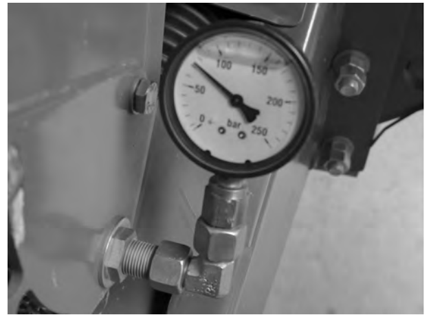
Fig. 122: Manometrul de pe traseul cablurilor de deasupra oiștei
