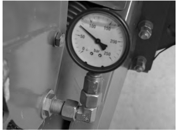
Sl. 122: Manometar na vođici kablova iznad rude
