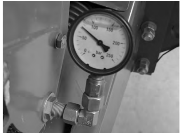
Att. 122: Manometrs pie kabeļa izvada caur jūgstieni
