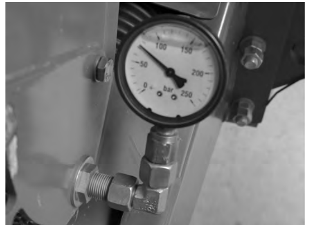
Kuva 122: Painemittari kaapelikanavassa vetoaisan yläpuolella
