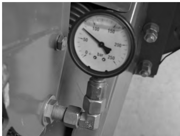
Sl. 122: Manometar na kabelskoj vodilici iznad ruda
