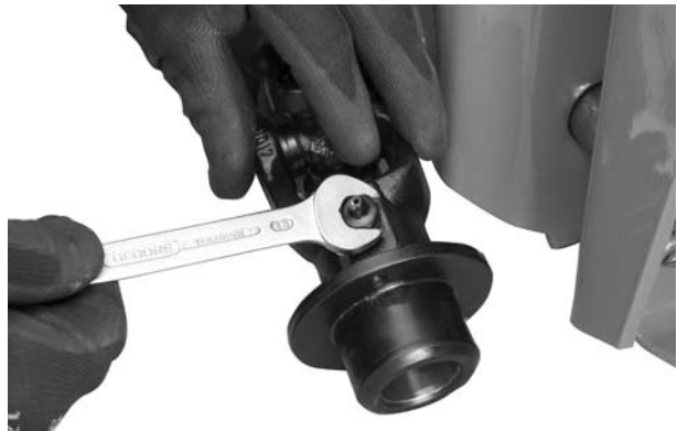
Εικόνα 2: Χαλάρωση στομίου εισαγωγής γράσου
