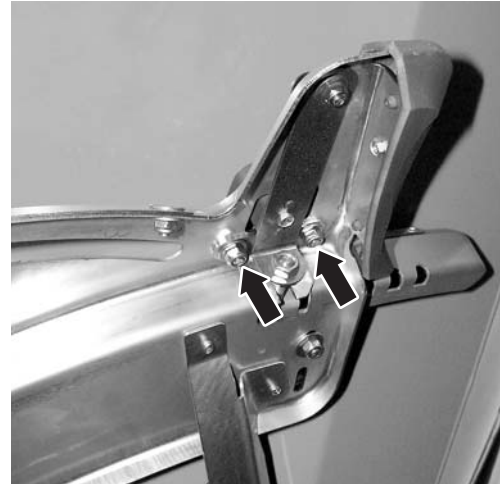
Εικόνα 29: Χαλάρωση ελάσματος ευθυγράμμισης σημείου εφαρμογής
