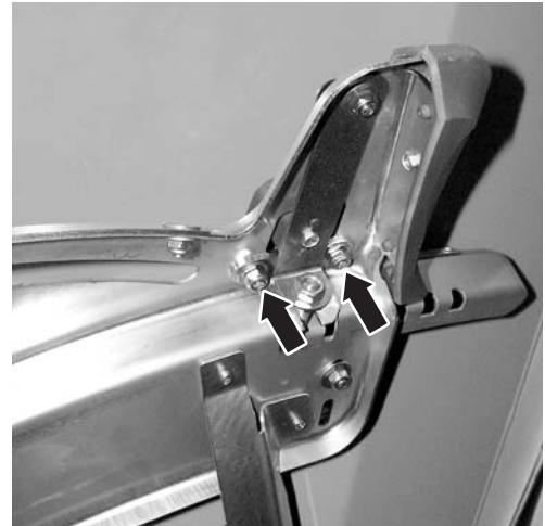
Εικόνα 34: Χαλάρωση ελάσματος ευθυγράμμισης σημείου εφαρμογής
