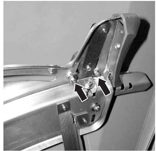
Εικόνα 10.26: Χαλάρωση ελάσματος ευθυγράμμισης σημείου εφαρμογής
