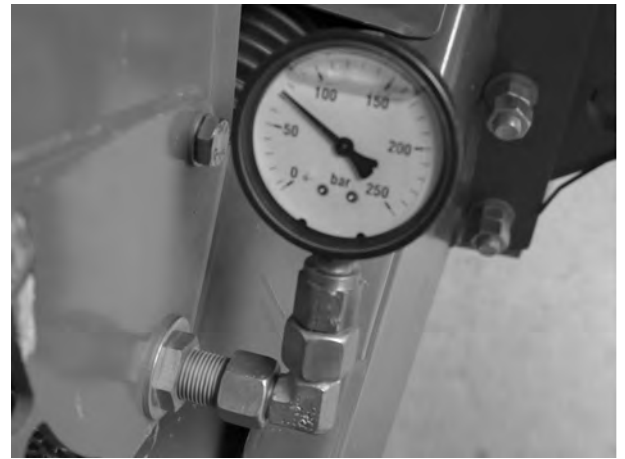
Ilust. 115: Manómetro en la guía de cable por encima de la barra
