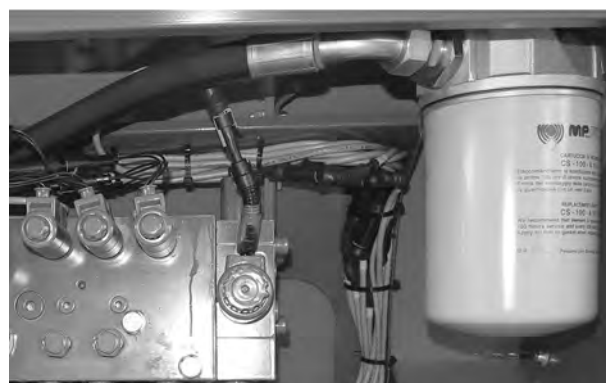
Att. 105: Vadības bloka eļļas filtrs
