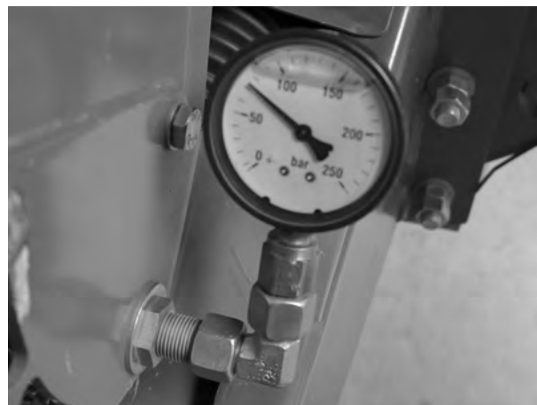
Obr. 115: Manometr na kabelovém vedení nad ojí
