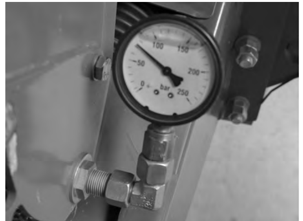
Att. 122: Manometrs pie kabeļa izvada caur jūgstieni
