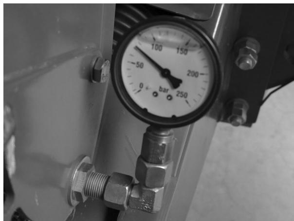
Kuva 9.16: Painemittari kaapelikanavassa vetoaisan yläpuolella
