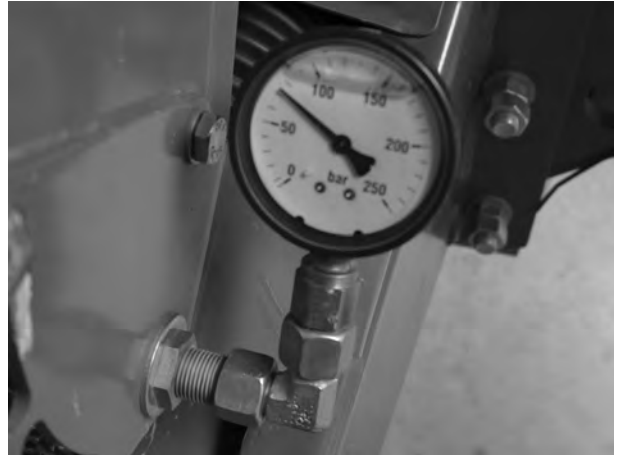
Figure 9.16 : Manomètre sur le guide-câbles sur timon
