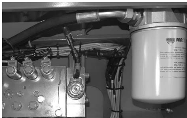
9.27 ábra: Vezérlőblokk olajszűrője
